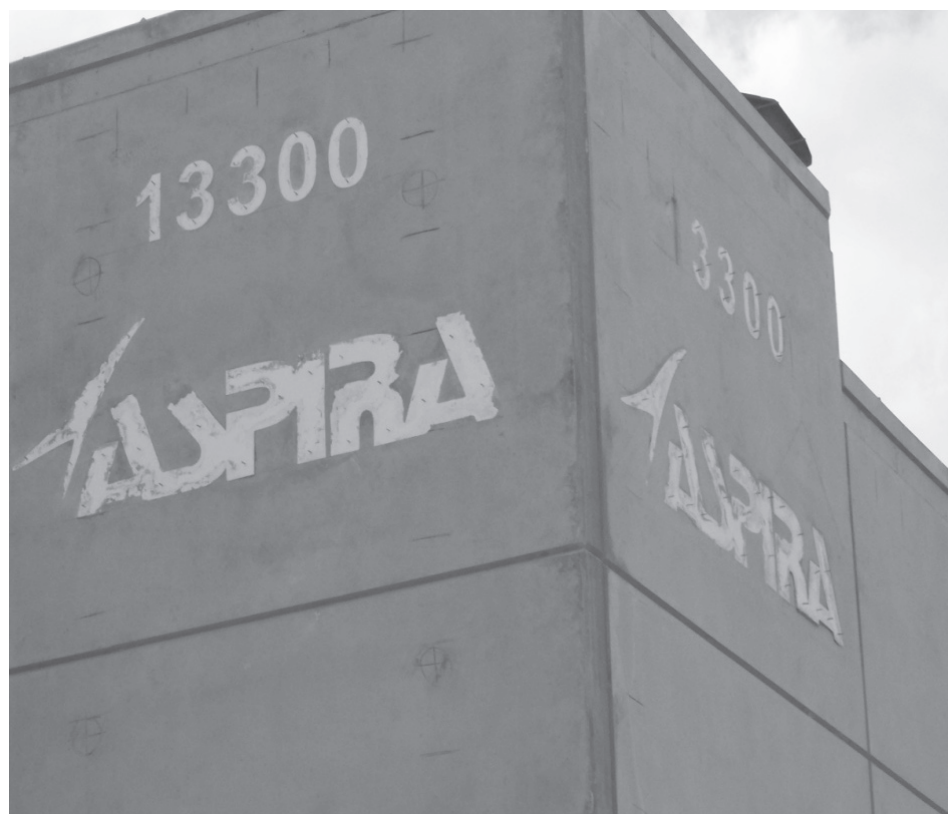
La escuela de North Miami ("Charter North") en plena construcción, usando el sistema de paredes preconstruídas.
